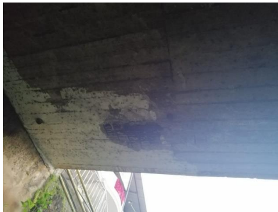
Figura 1.2 Exposición de varillas de refuerzo en losa Fuente: [Propia]
