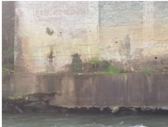
Figura 1.4 Socavación en estribo derecho con vista aguas abajo
