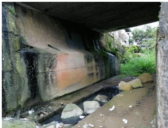
Figura 1.3 Fisuras en el Estribo izquierdo con vista aguas abajo. Fuente: Propia
