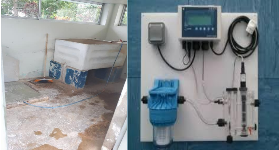
Ilustración 2.10 sistema de cloración por goteo.
