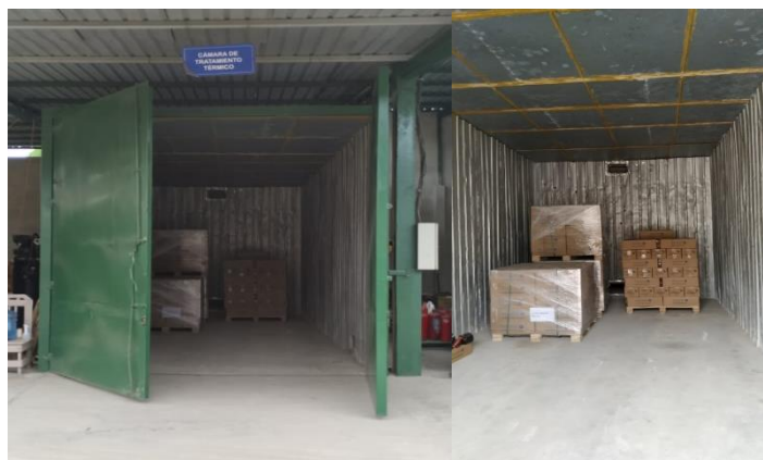
Figura 1.5 Cámara de Tratamiento Térmico Interior de Cámara [Paleta Escobar-2020]
