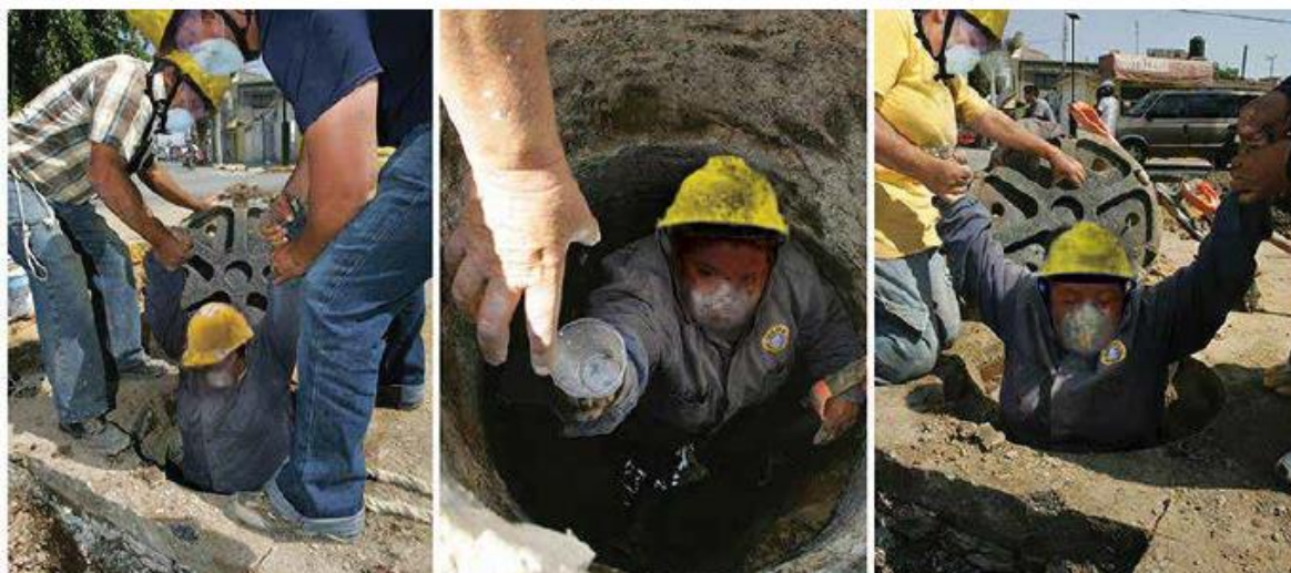
Figura 3-58 Falta de protección en lugares confinados. Fuente: Conagua
