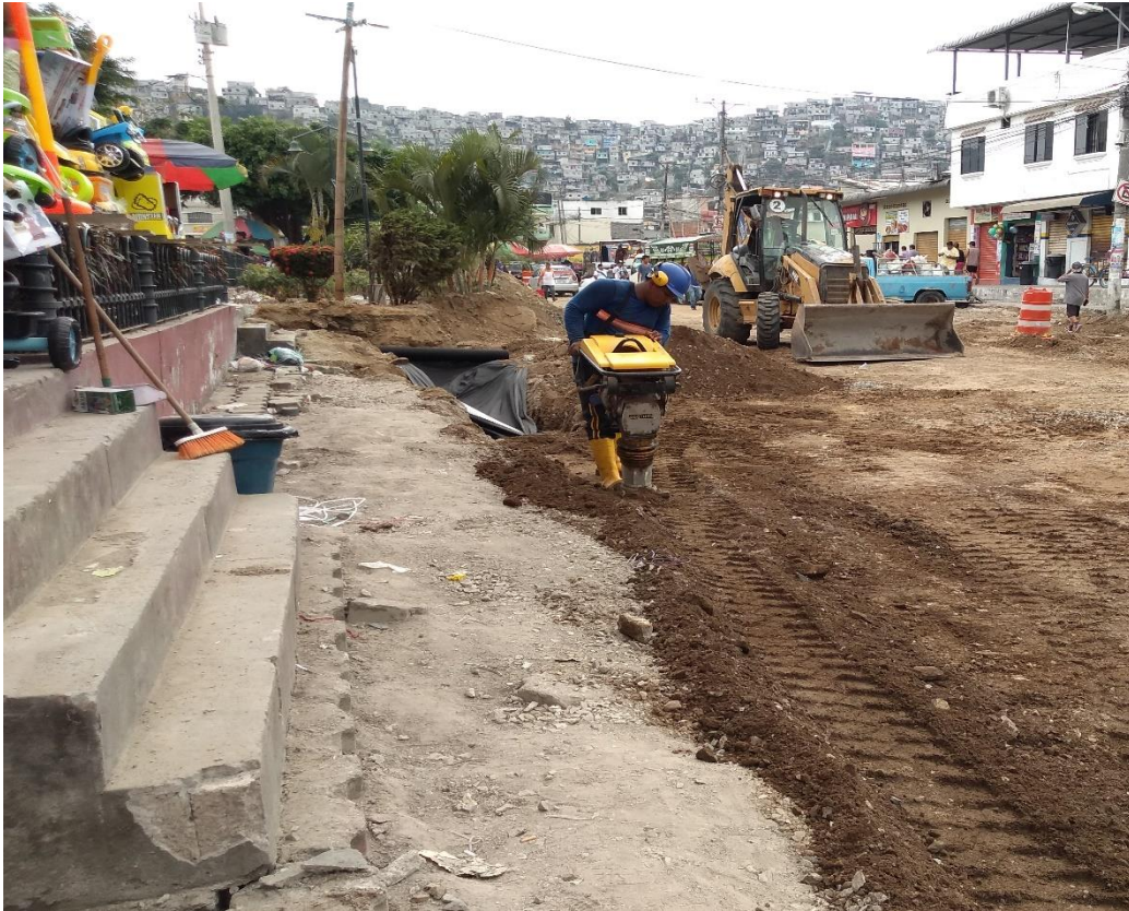
Figura 3-32 Compactación sobre con maquinaria manual sobre la instalación y relleno del geotextil
