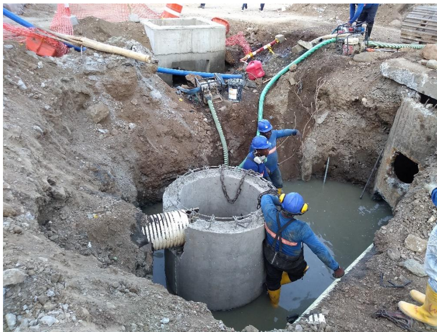
Figura 3-13 Presencia de agua durante instalación de cámara
