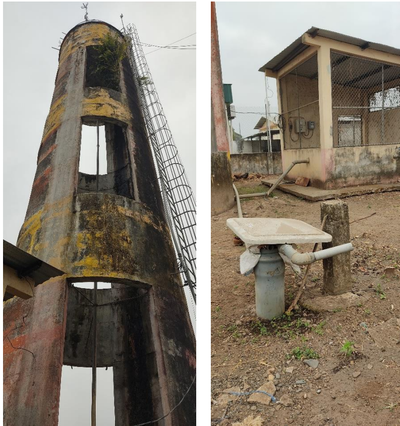
Ilustración 1.3.5 Infraestructura de sistema de captación de agua subterránea.
