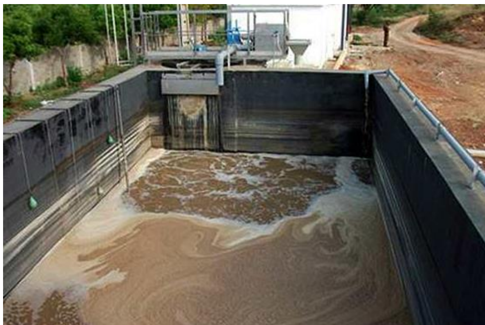
Figura 3. Agua residual industrial en proceso de tratamiento.
