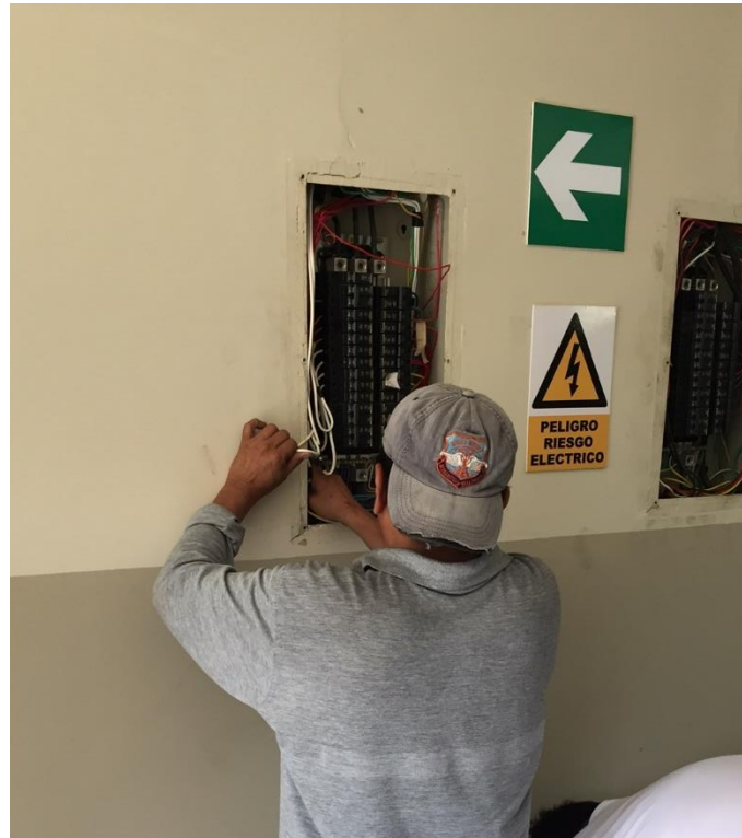
Ilustración 35.- Revisión del panel de breakers
