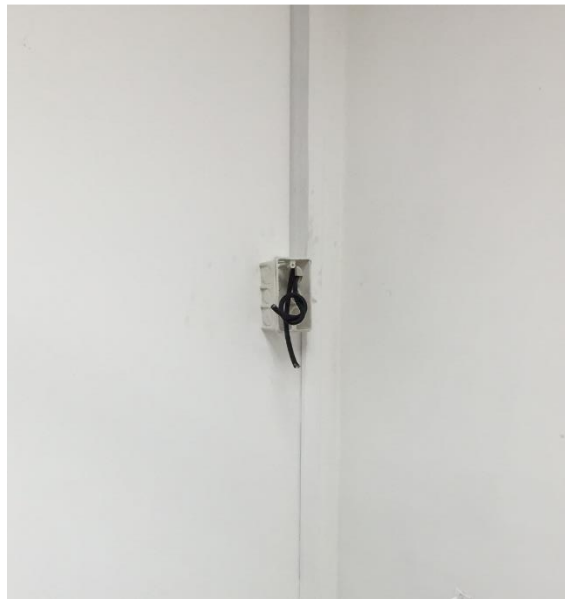
Ilustración 37.- Cable de corriente para los extractores
