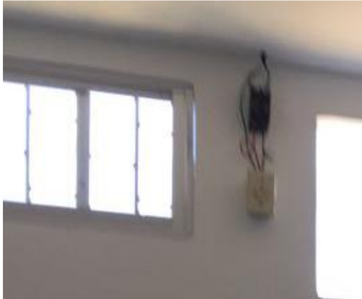
Ilustración 38.- Punto eléctrico de 220V y breaker
