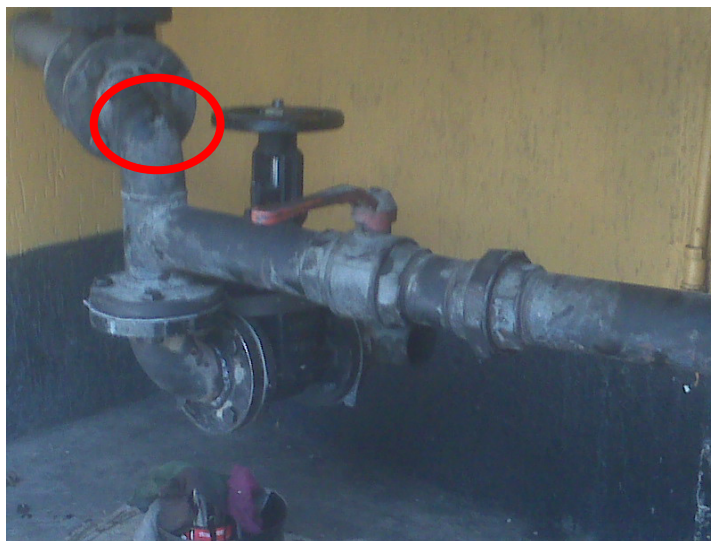
FIG. 4.2 – UBICACIÓN DE VÁLVULA DE ALIMENTACIÓN DE TANQUE DE FUEL OIL
