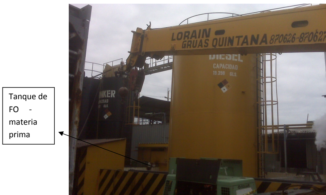
FIG. 4.1– UBICACIÓN DEL TANQUE DE FUEL OIL
