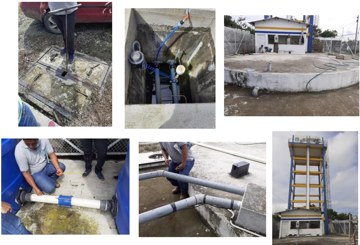
Figura 4.1. Sistema de Bombeo y Reservorio Los Amarillos.
