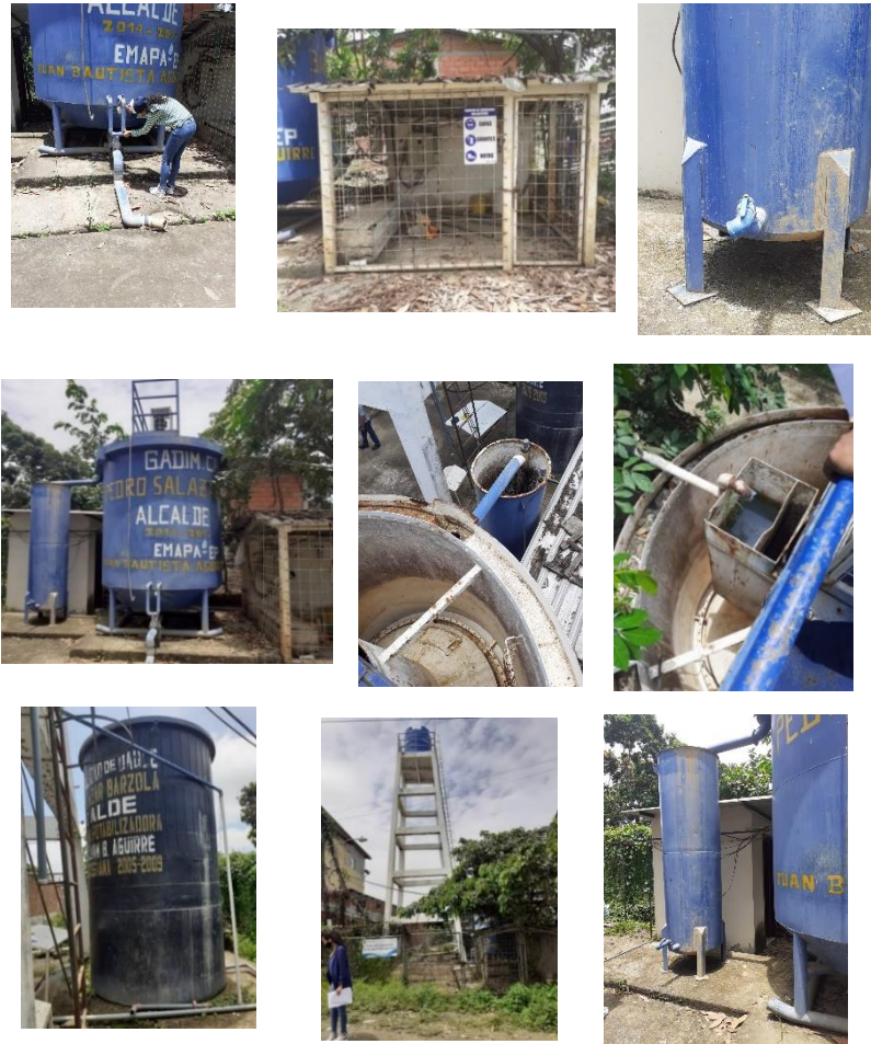
Figura 4.3. Planta de Tratamiento JBA.
