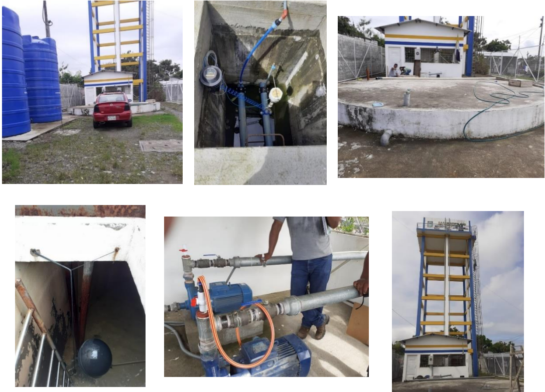
Figura 2.8. Sistema de Bombeo y Reservorio "Los Amarillos"
