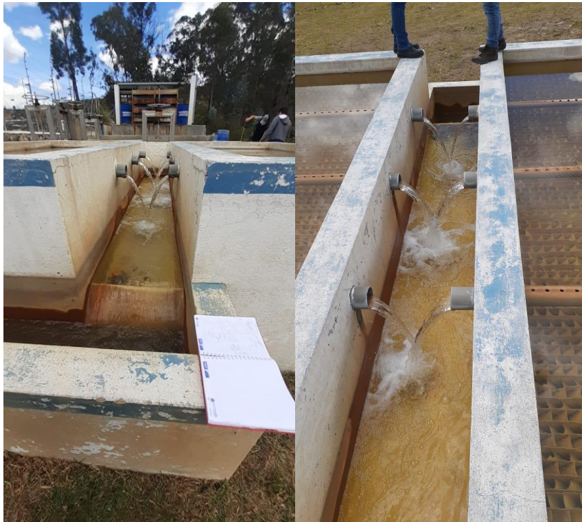
Ilustración 2-8 Salida del agua clarificada en el proceso de sedimentación [Salcedo & Sevillano, 2020]
