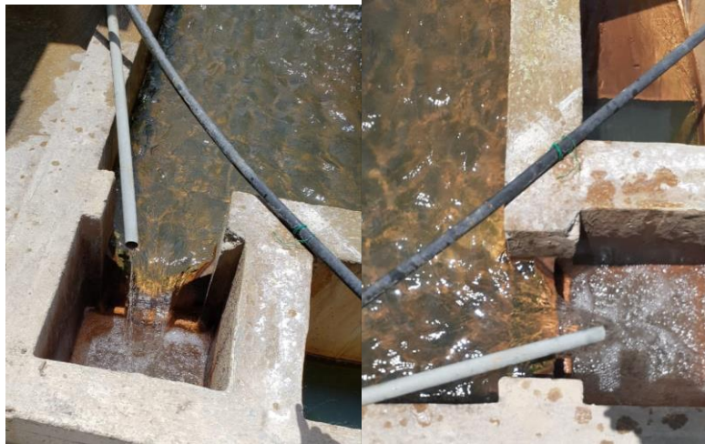
Ilustración 2-5 Vertedero de mezcla rápida de la PTAP [Salcedo & Sevillano, 2020]
