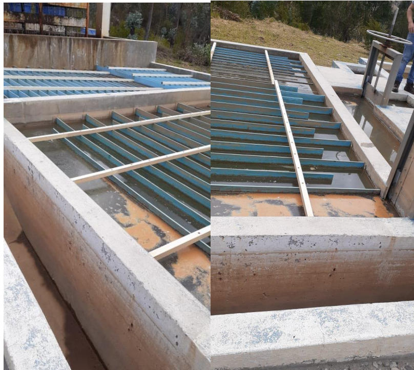
Ilustración 2-6 Floculador hidráulico de la PTAP “El Descanso” [Salcedo & Sevillano, 2020]
