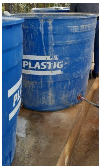
Ilustración 2-3 Tanques de almacenamiento de la PTAP “El Descanso” [Salcedo & Sevillano, 2020]
