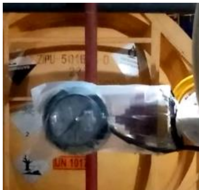
Figura 12. Manómetro con switch de presión instalado en la descarga de la bomba
