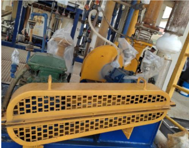
Figura 15. Aspirador de cloro K-401 integrado por motor, bandas y voluta
