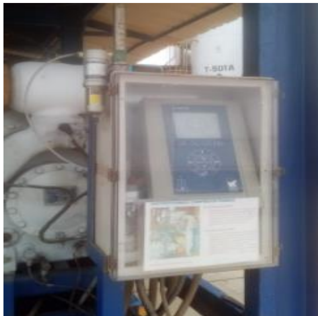
Figura 22. Cajetín que mantiene libre de humedad el computador UNISAB del compresor de freón Sabroe.
