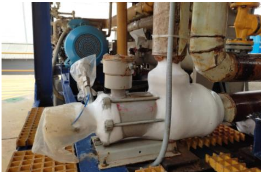
Figura 14. Sensor de temperatura y vibración instalado
