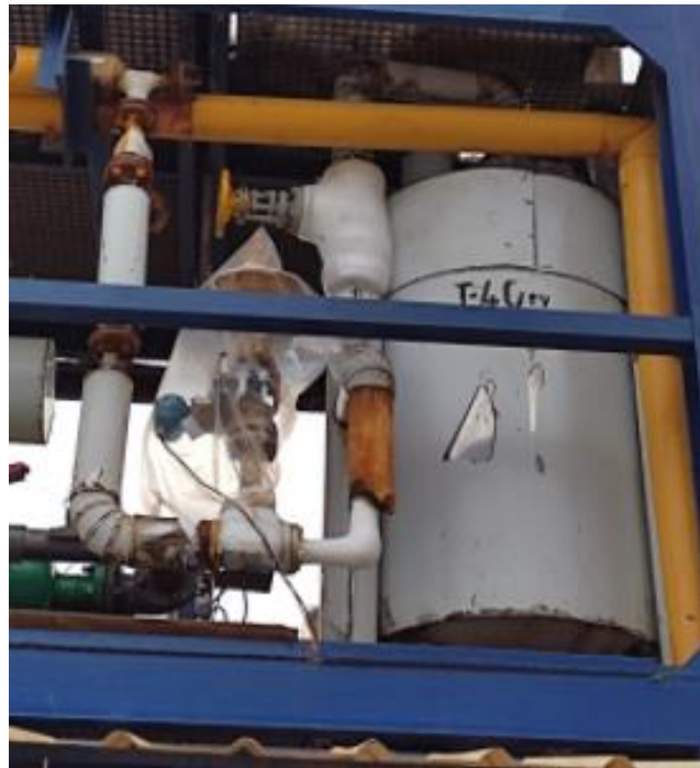
Figura 19. Tanque T-406 que recibe el cloro líquido que se genera en el licuador
