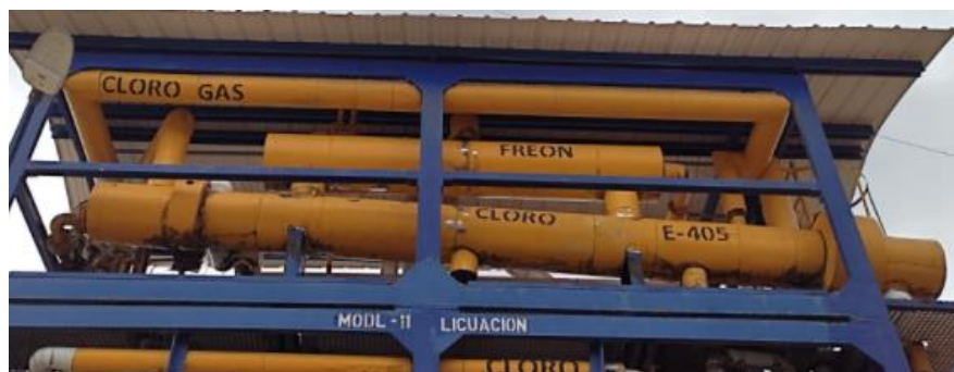
Figura 23. Licuador de cloro/ Evaporador de freón E-405
