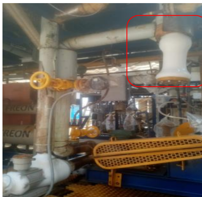
Figura 10. Instalación de bota que retiene las virutas de hierro antes de que sean succionadas por la bomba de cloro líquido
