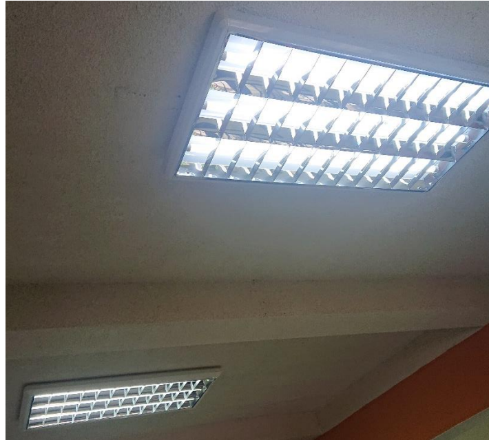
Figura B.8 Luminarias T 12 de 32 W para oficinas
