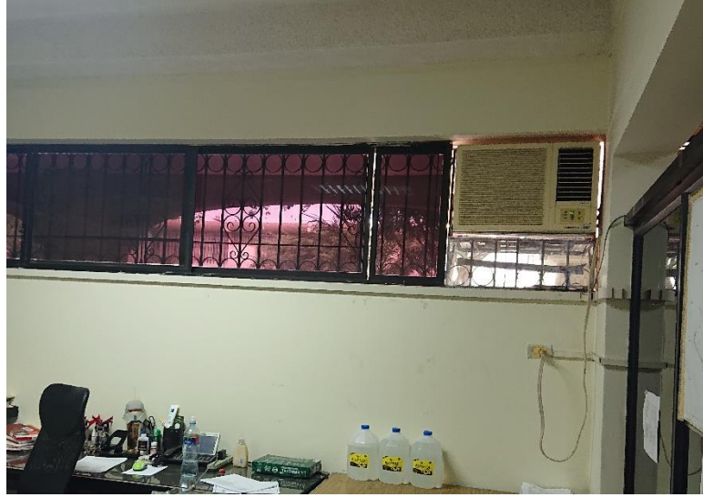
Figura B.6 Aires acondicionados de ventana de 12000 BTU para oficina
