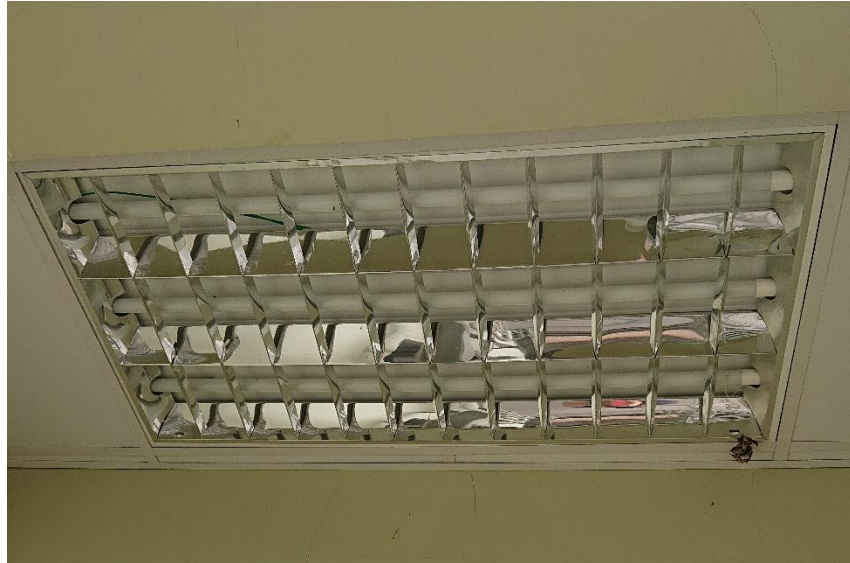
Figura B.4 Luminarias T 12 de 32 W en la universidad
