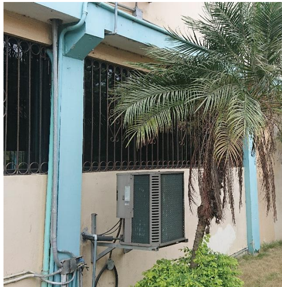
Figura B.3 Aires acondicionados de 36000 BTU para aulas
