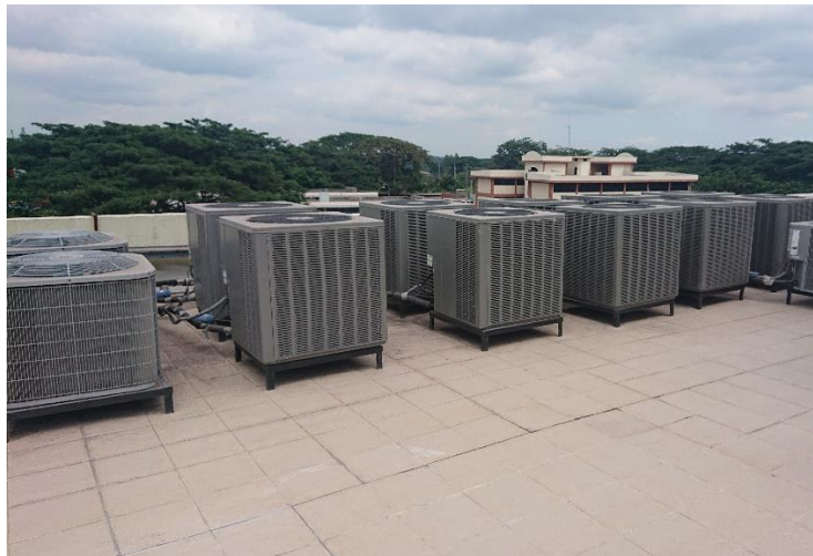
Figura B.9 Conteo de aires acondicionados en edificio CRAI
