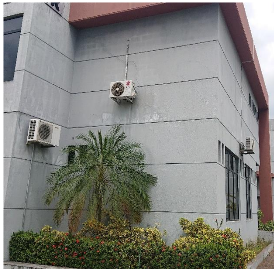
Figura B.13 Conteo de los aires acondicionados split en las paredes de los edificios
