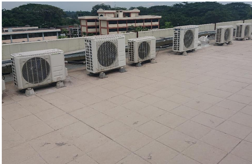
Figura B.7 Aires acondicionados split de 12000 BTU para oficinas
