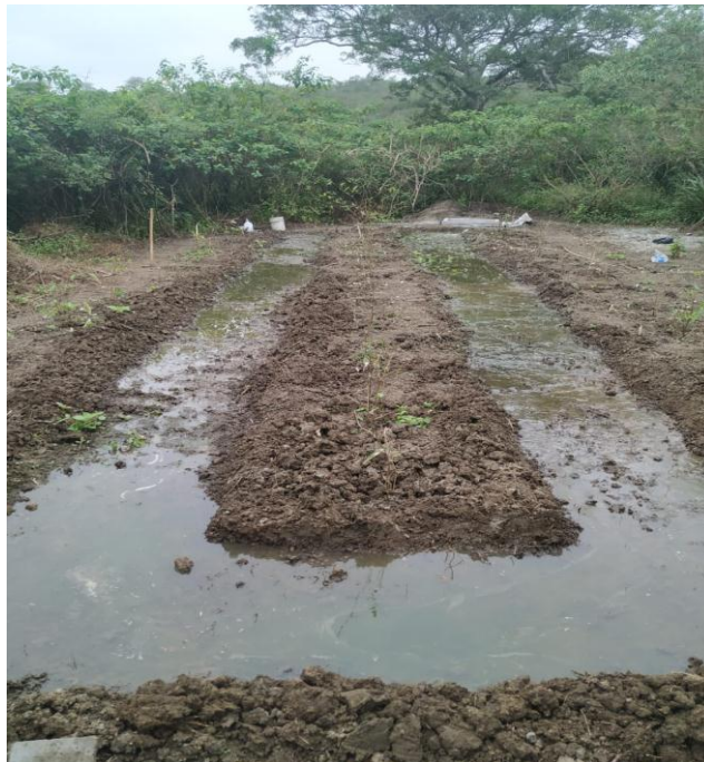
Anexo 2.D. Planta piloto de tratamiento de aguas residuales a través de un sistema de filtros verdes en funcionamiento.
