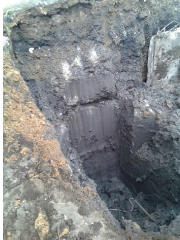
Figura 3.24 Zanja para hincado de tablestacas. (Foto tomada en obra por la autora, junio 2014)
