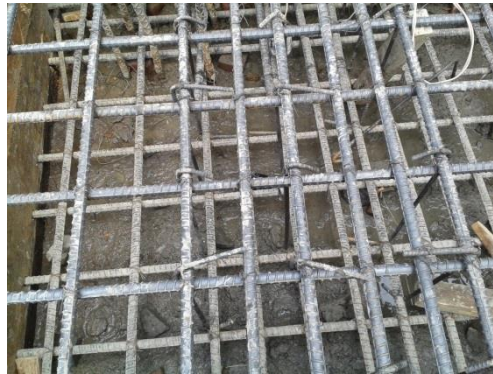
Figura 3.35 Armado de la viga de cimentación. (Foto tomada en obra por la autora, agosto 2014)
