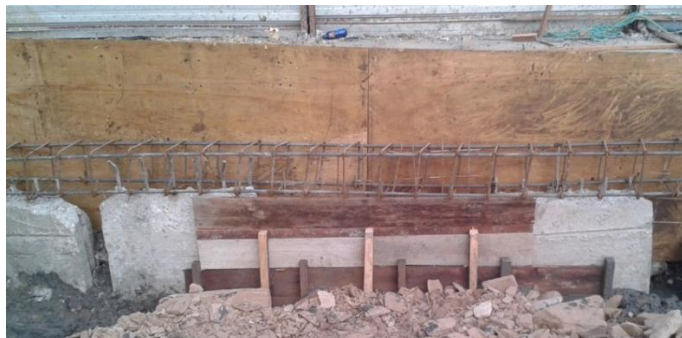
Figura 3.26 Armado de viga de coronación. (Foto tomada en obra por la autora, julio 2014)
