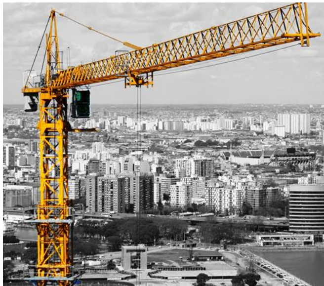
Figura 3.6 Grúa tipo torre.
