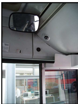
Gráfico 2.1. Instalación de cámaras en el Bus.
