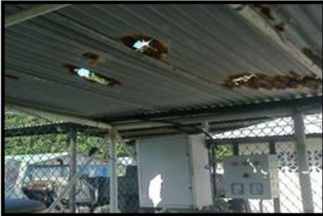
Gabinete de control en Calime
