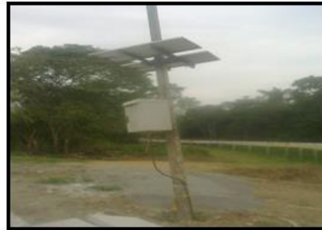
Gabinete de las baterías del panel solar, con su respectivo radio para accionar los actuadores y permitir el paso del agua hacia el CALIME y BATALLON
