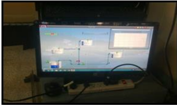
Monitoreo del SCADA en el Dpto. de Operaciones del BIMESM
