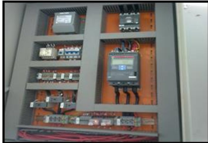
Bomba sumergible integrada al SCADA, arrancador suave (cuarto de bombas)
