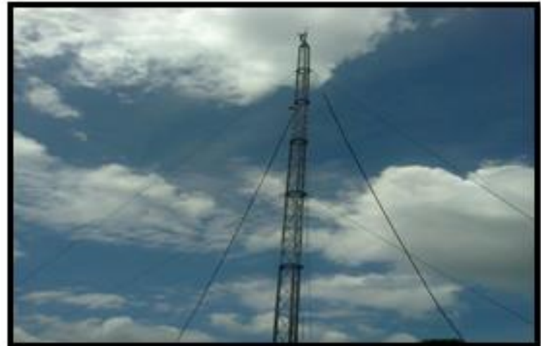
Radio ubicado en la torre del CALIME (Frente al Terminal Marítimo de Balao)
