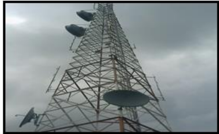
Radios ubicados en la torre No. 1 del Terminal Marítimo de Balao (2do salto)
