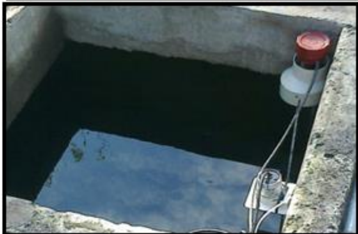
Sensores de niveles de agua, cisterna plataforma No.1
