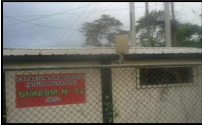
Radio TRANGO BROADBAND ubicado en la estación de bombeo
