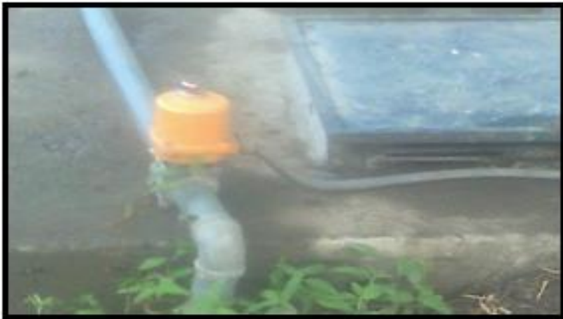
Actuador en la estación de bombeo
