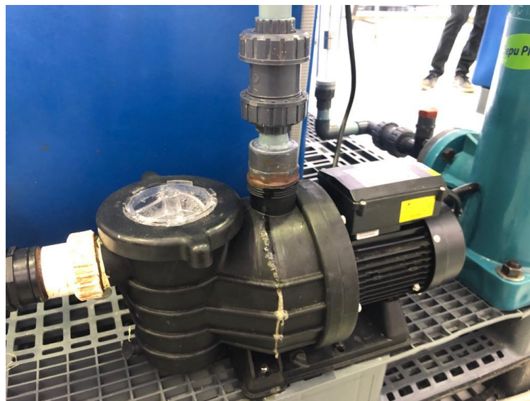
Figura D.39 Bomba en funcionamiento.
