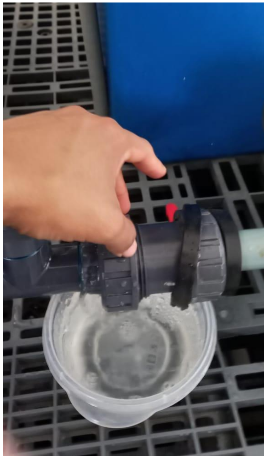
Figura D.42 Prueba de la válvula de retención de la estación 2
