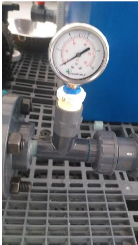
Figura D.11 Instalación de manómetros
