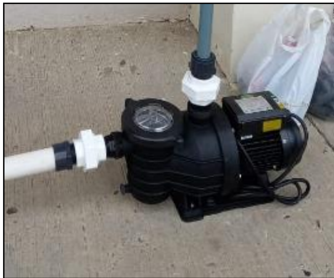
Figura 1.3 Bomba de recirculación [Elaboración propia]
