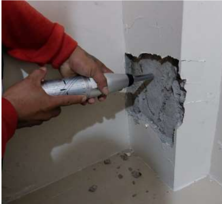
Ilustración 10 Daño severo en columna A6 – 3er Piso
