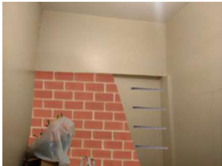
Ilustración 23 Rehabilitación problema grave 1
