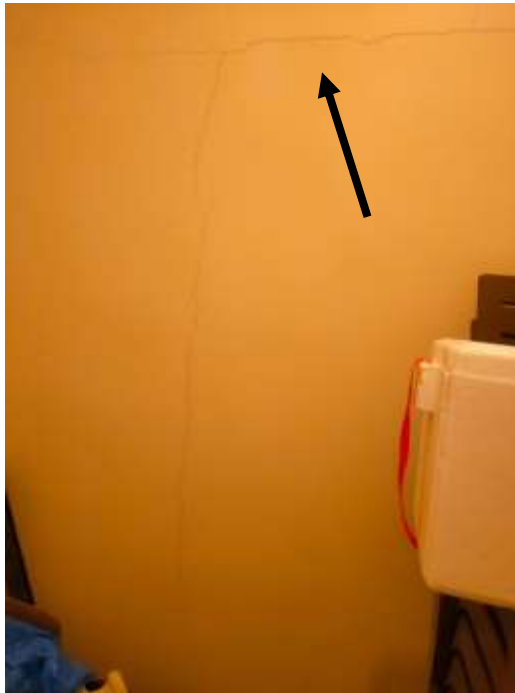
Ilustración 7 Fisuras por malos procesos constructivos – 1er Piso
