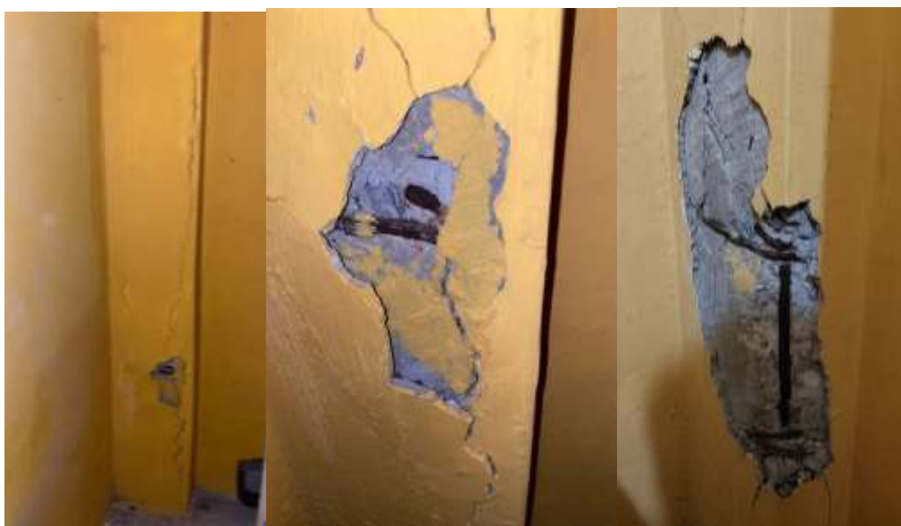
Ilustración 9 Daño severo en columna A6 – 2do Piso
