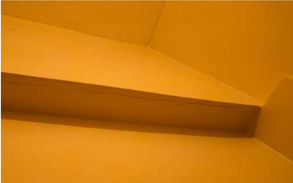
Ilustración 5 Grieta inferior viga tramo C6-D6 – Primer piso
