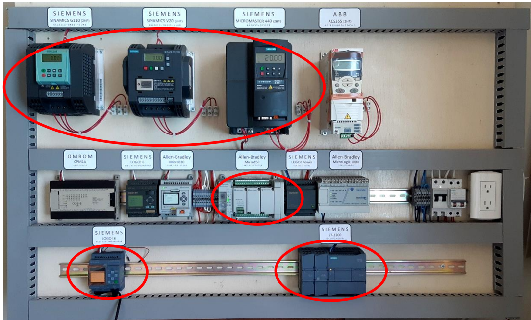
Figura 1.1 Tablero eléctrico encendido y operativo donde constan los PLC's y accionamientos de motores eléctricos a ser empleados en el presente proyecto de titulación (elipses color rojo)
