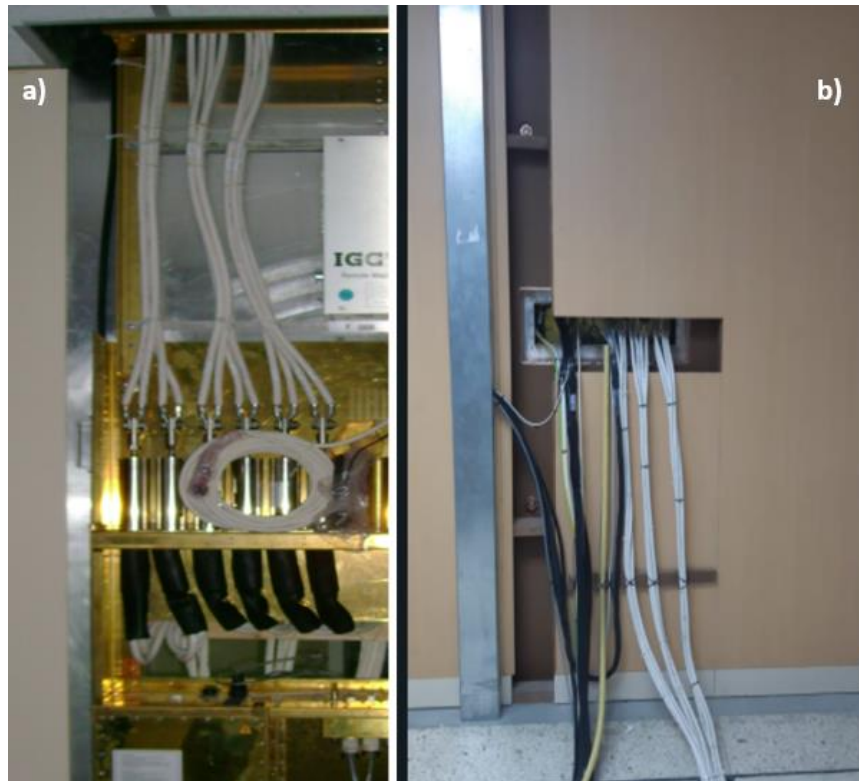
Figura 4.30 Caja de transferencia a) Interior b) Exterior
