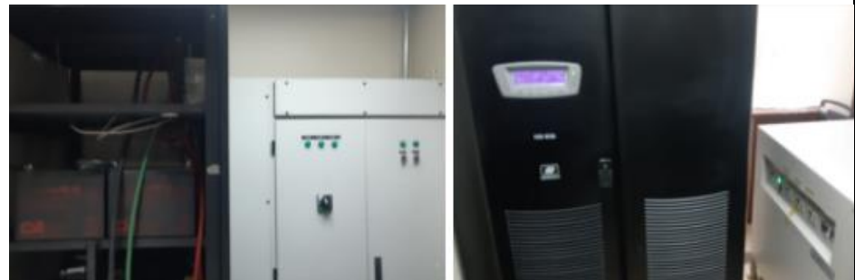
Figura 4.38 Control de alimentación eléctrica, tablero de distribución y UPS
