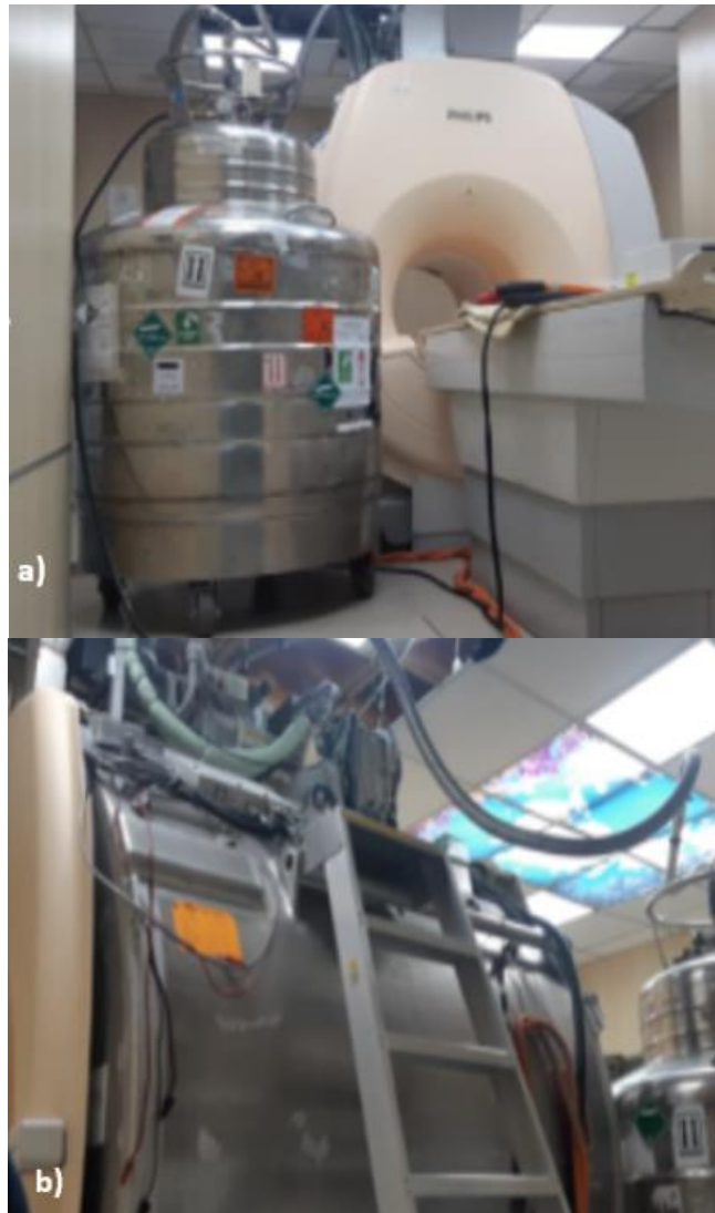
Figura 4.31 Recarga de Helio a) Tanque de Helio b) Control de presión
