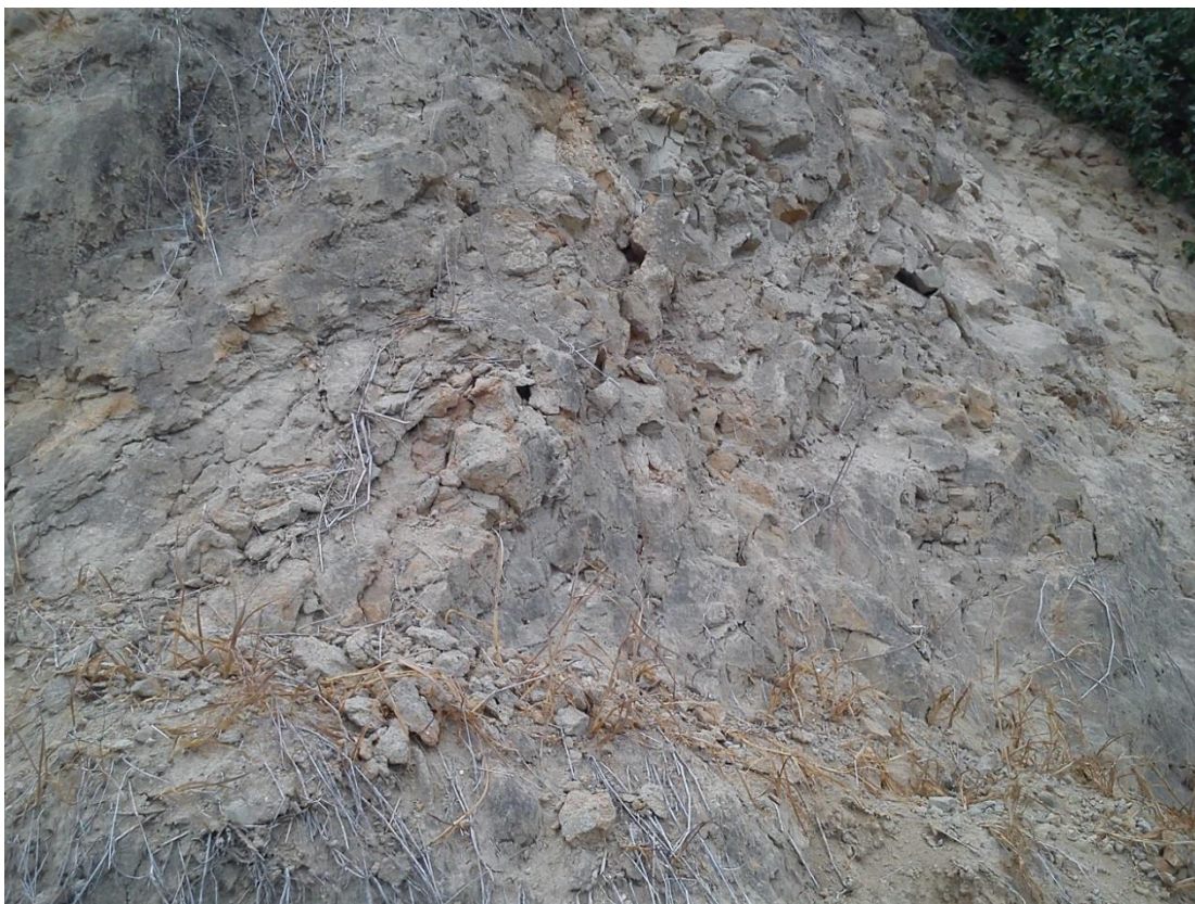
Imagen 2. 11 FRACTURAS EN ROCA
