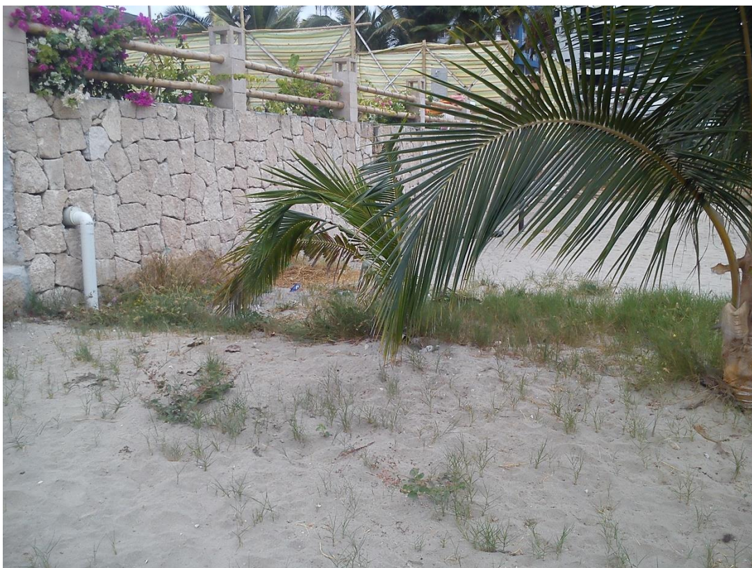
Imagen 2. 5 DESCARGA INAPROPIADA DE AGUAS RESIDUALES
