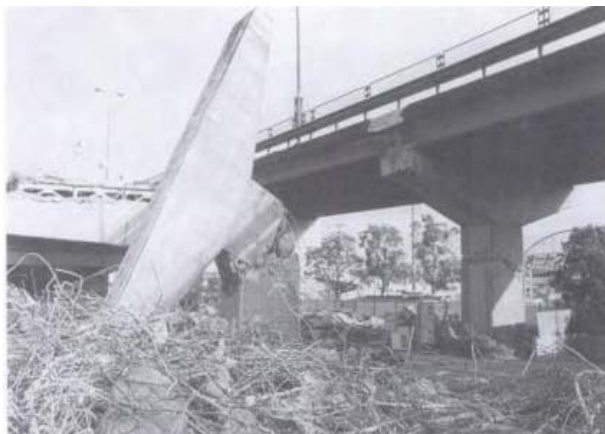
Figura 3.21: Falla por flexión y corte en la mitad de la altura de la pila del paso elevado de la ruta 43/2, debido a la terminación prematura del refuerzo longitudinal durante el Terremoto de Kobe. (Tomada de Priestley, Seible y Calvi, 1996)
