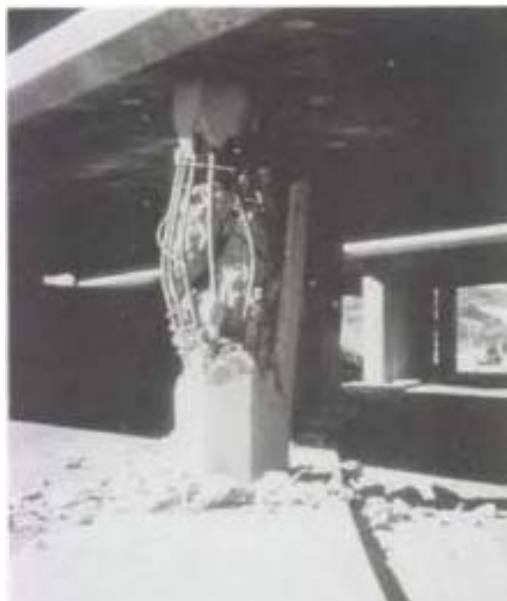
Figura 3.24: Falla a cortante fuera de la región de la articulación plástica en el sismo de San Fernando. (Tomada de Priestley, Seible y Calvi, 1996)
