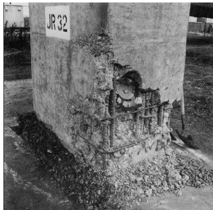
Figura 3.18: Falla por falta de longitud de traslape en la base de la columna. Terremoto de Loma Prieta, 1989. (Tomada de Priestley, Seible y Calvi, 1996)
