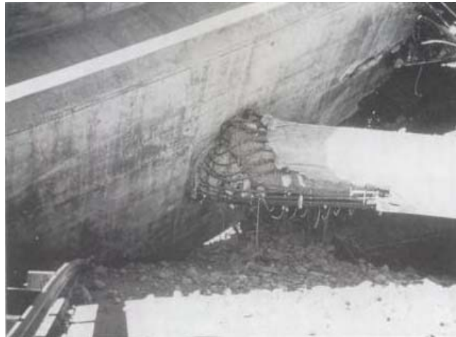
Figura 3.19: Falla del confinamiento en la parte superior de la columna durante el sismo de San Fernando en 1971. (Tomada de Priestley, Seible y Calvi, 1996)
