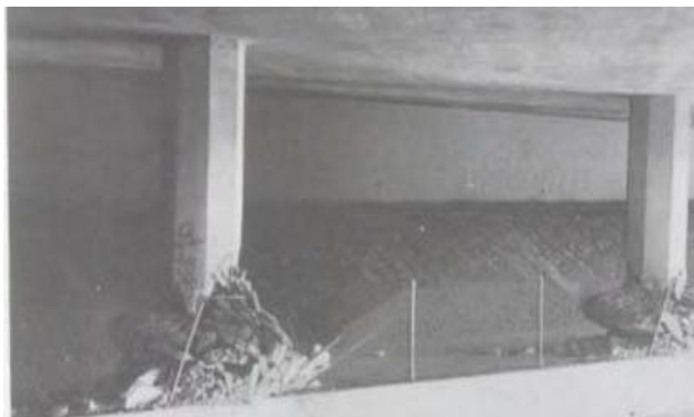
Figura 3.20: Rótulas plásticas en columnas restringidas por un muro que las conecta en el Puente sobre el Canal Bull Creek Canyon. (Tomada de Priestley, Seible y Calvi, 1996)
