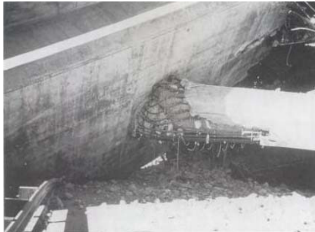
Figura 3.19: Falla del confinamiento en la parte superior de la columna durante el sismo de San Fernando en 1971. (Tomada de Priestley, Seible y Calvi, 1996)
