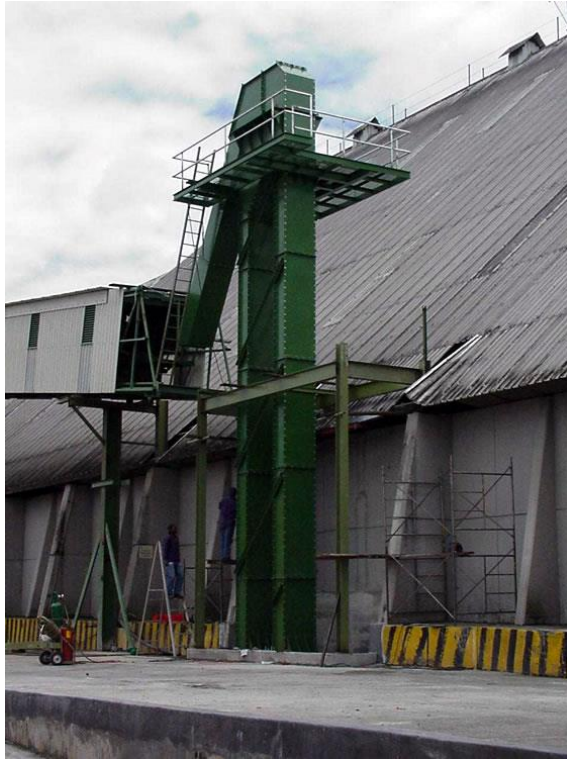
Ilustración 2: Elevador de cangilones
