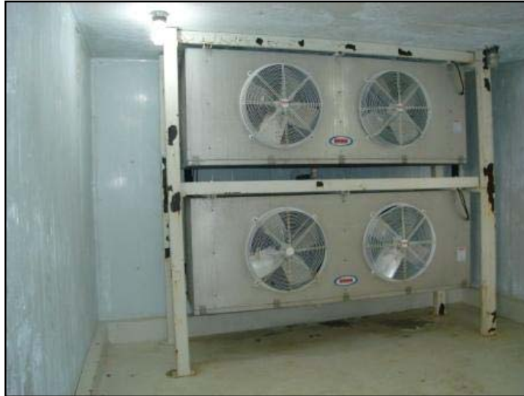
Figura 3.43: Congeladores del almacén del Producto Terminado
