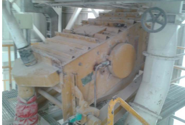
FIGURA 5.10 - EQUIPO VIBRATORIO CRIBA FINALIZADA
