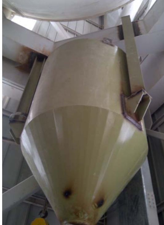
FIGURA 5.14 - SILO INSTALADO CON SU SOPORTERÍA.
