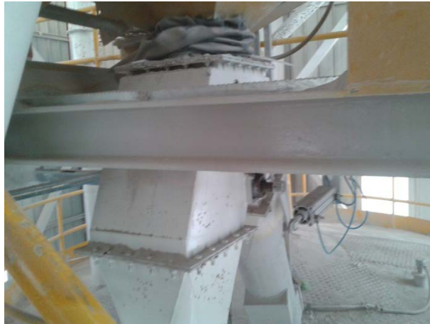
FIGURA 5.5 - VÁLVULA DE DOS VÍAS INSTALADA
