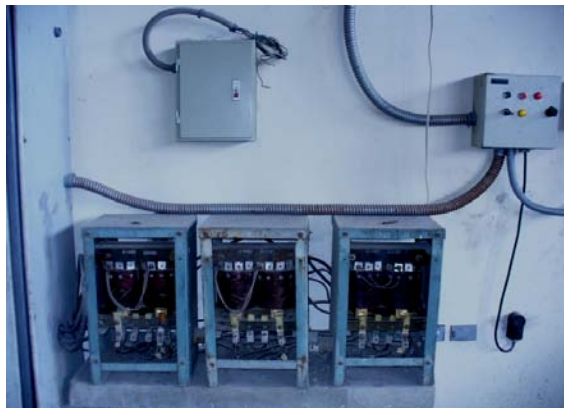
FIGURA 3.6 INSTALACION ELECTRICA NO SEGURA
