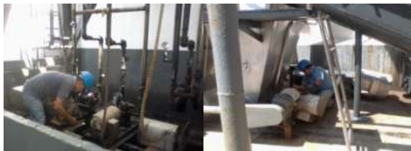
Figura 7.6 Principales bombas de la planta
