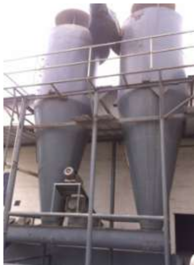
Figura 3.7 Tolvas de recepción
