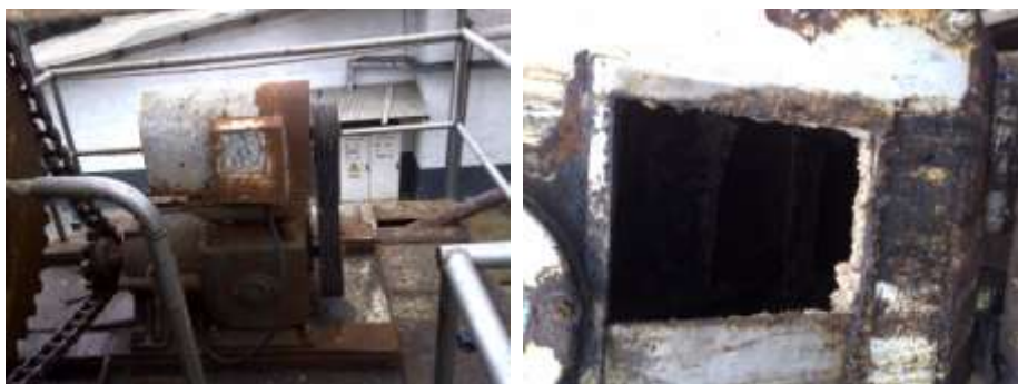
Figura 3.15 Equipos en mal estado
