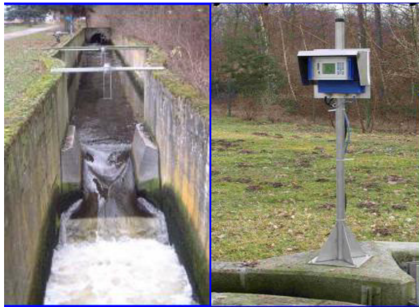
FIGURA 3.4. UNIDAD PROGRAMABLE A BATERIA OPERANDO EN UNA ESTACION DE AFORO
