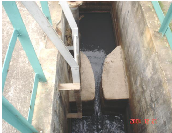
FIGURA 2.11 AFORADOR PARSHALL EN LA PLANTA DE TRATAMIENTO DE EFLUENTES DE REE.
