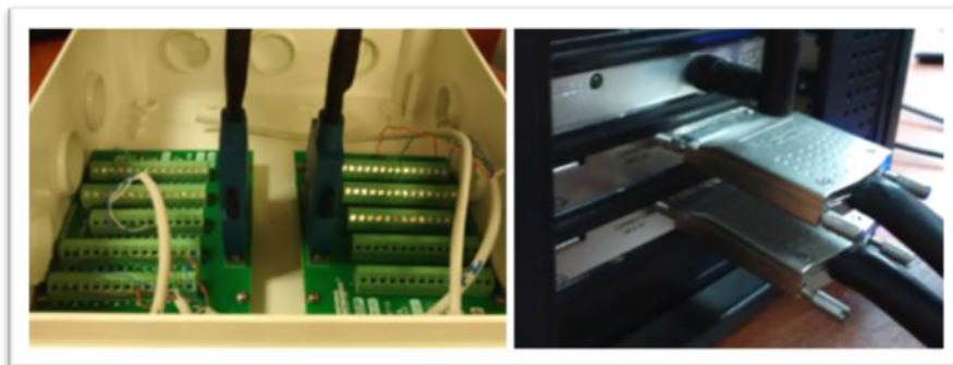
Figura 1.59. Detalle de la caja de conexiones, borneras y tarjetas de adquisición de datos
