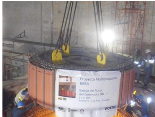
Figura 5. Rotor del Generador
