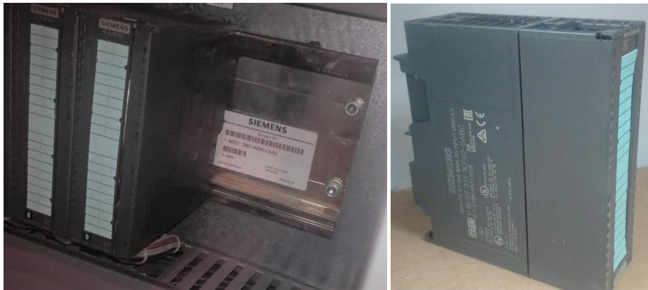
Figura 28. Instalación de tarjeta analógica
