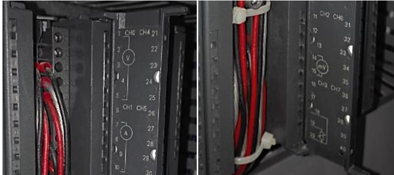
Figura 29. Conexión de cables entradas de corriente SM331
