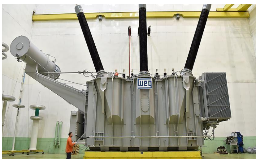
Figura 1-5: Transformador marca WEG de 300 MVA
