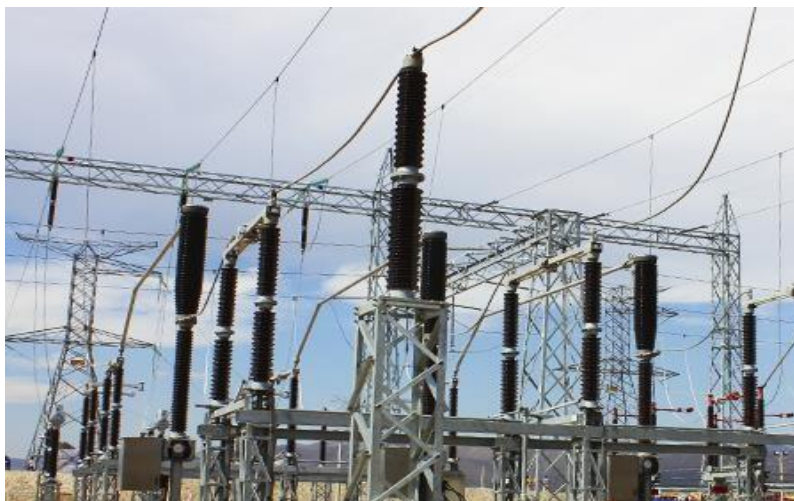
Figura 1-6: Subestación de 69 kV puesta en servicio
