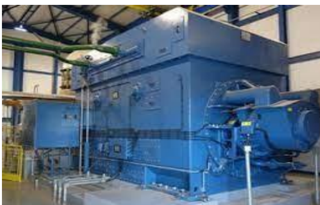
Figura 1-4: Turbogenerador de 13.8 kV 60 Hz
