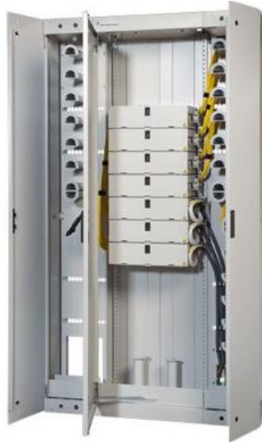
Figura 1.17 Rack con ODFs [23]
