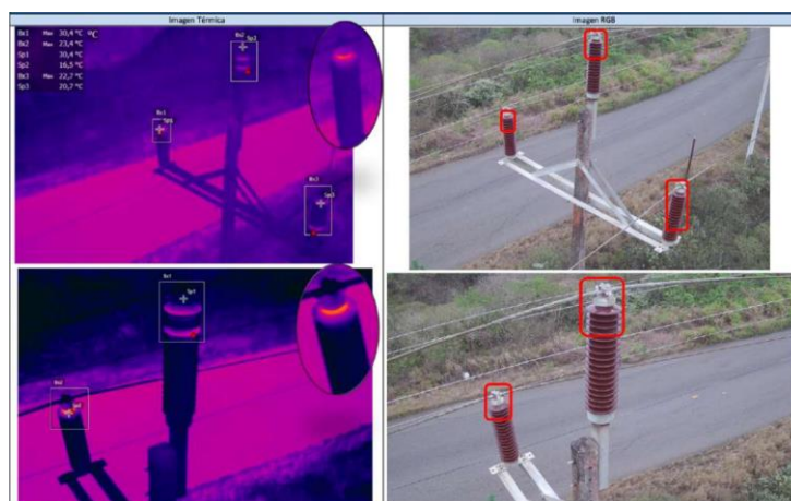
Figura 1.13 Diagnostico visual-térmico en sistemas eléctricos de subtransmisión [22]
