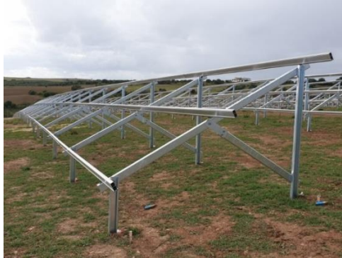
Figura 2.26 Estructura para paneles fotovoltaicos [17]
