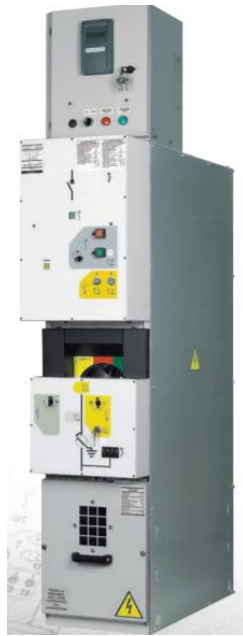
Figura 2.21 Celda de Media Tensión [12]
