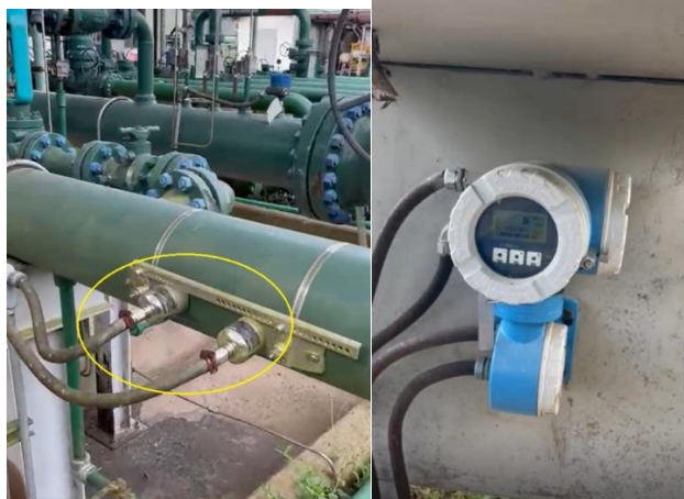
Figura 2.27. Sensores de flujo y su transmisor [Autores]
