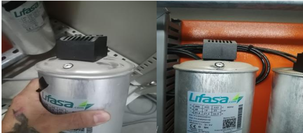
Figura 2-5 Capacitor reventado vs Capacitor normal
