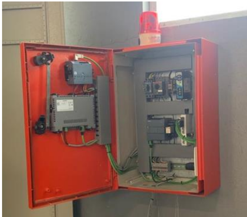
Figura 2-15 Tablero de control para la adquisición de datos de la planta
