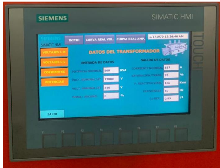
Figura 3-2 Datos del transformador en la HMI KTP 700
