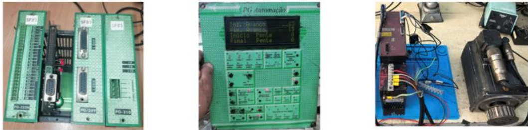
Fig. 2: Equipos obsoletos a modernizar
