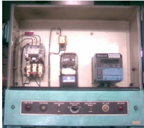
Fig. 6.2 Tablero de motores de calderas
