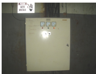
Fig. 1-8 Panel de Transferencia del Generador marca Caterpillar.
