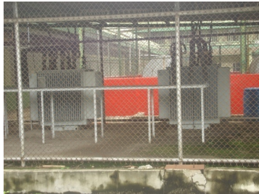
Fig. 1-12 Cuarto de Transformadores.
