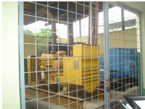
Fig. 1-6 Vista de los dos generadores.
