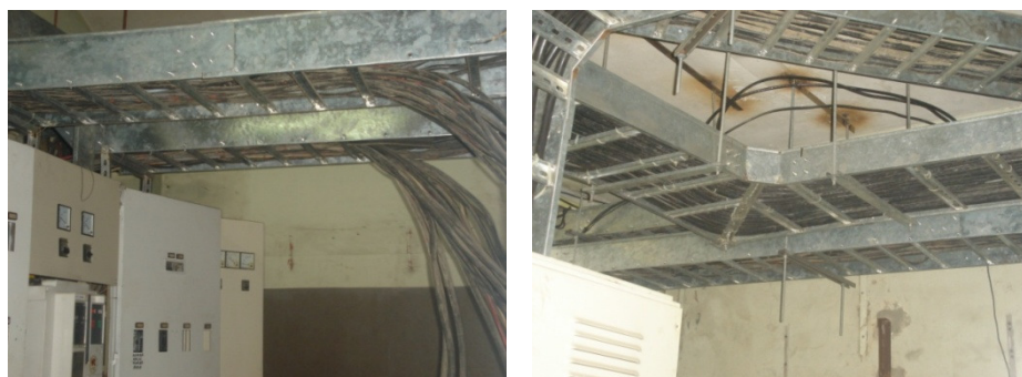
Fig. 1-10 Necesidad de Rediseño en Vías Aéreas de Cables Eléctricos.
