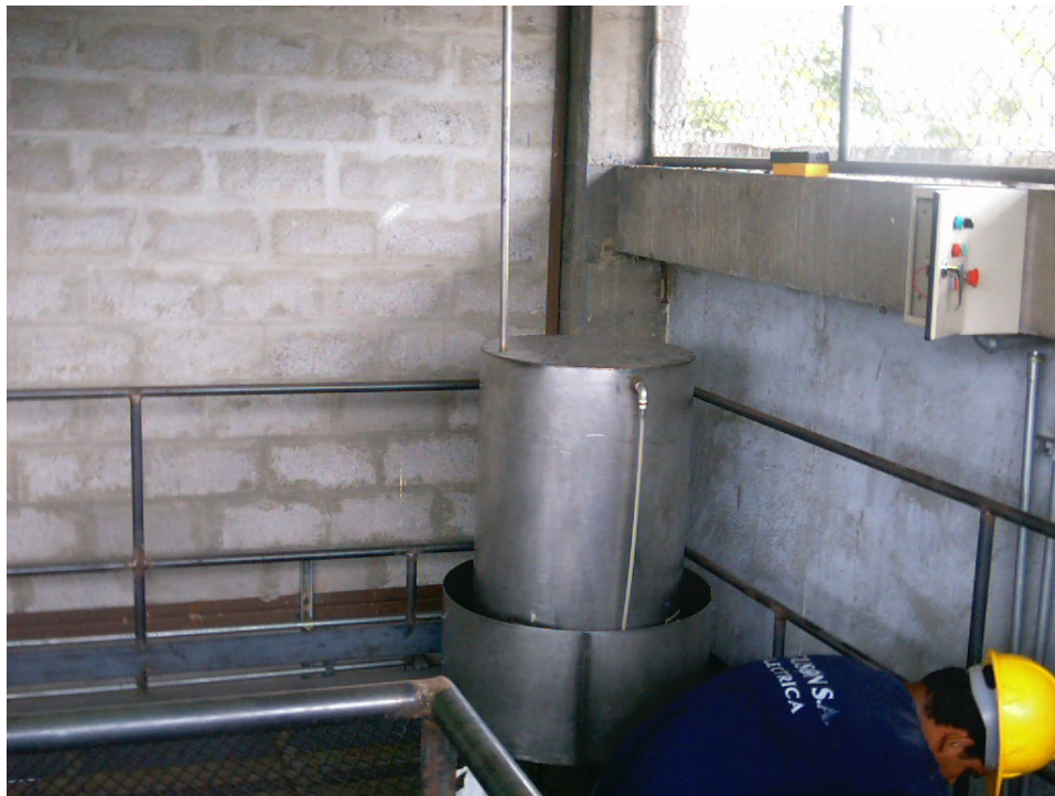
FIGURA 3.21. TANQUE RESERVORIO DE PROPILENGLICOL.
