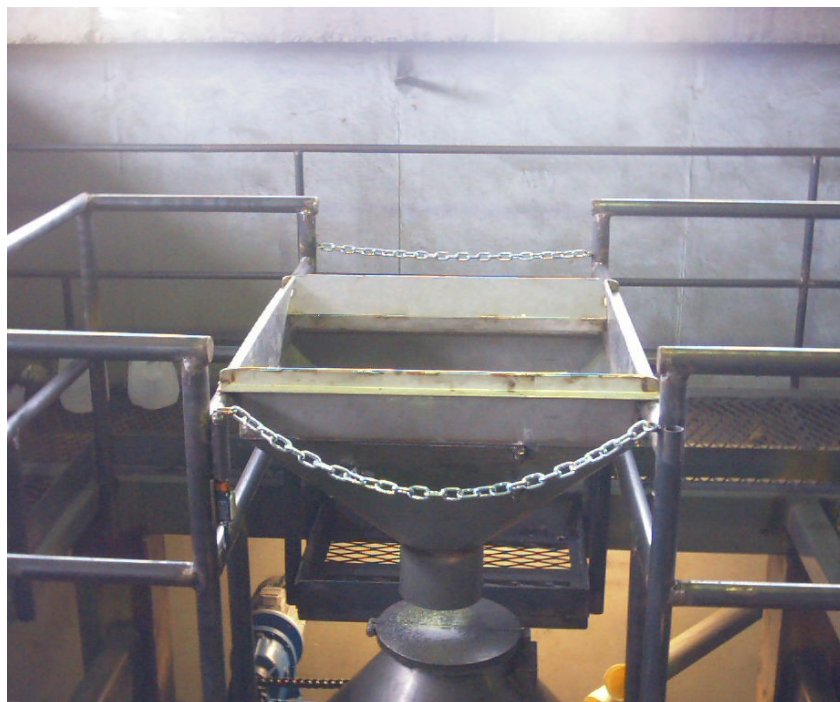
FIGURA 3.28. MICRO SWITCH DE SEGURIDAD EN ACCESO A ADMISION DEL MEZCLADOR.
