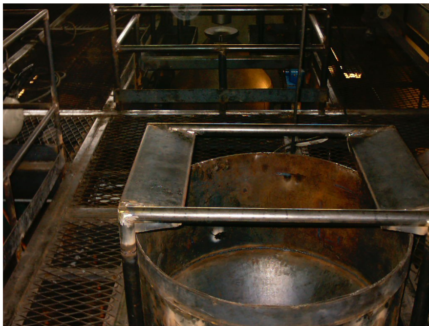
FIGURA 3.18. TOLVA PARA ALIMENTACION DE ZARANDA PARTE SUPERIOR.
