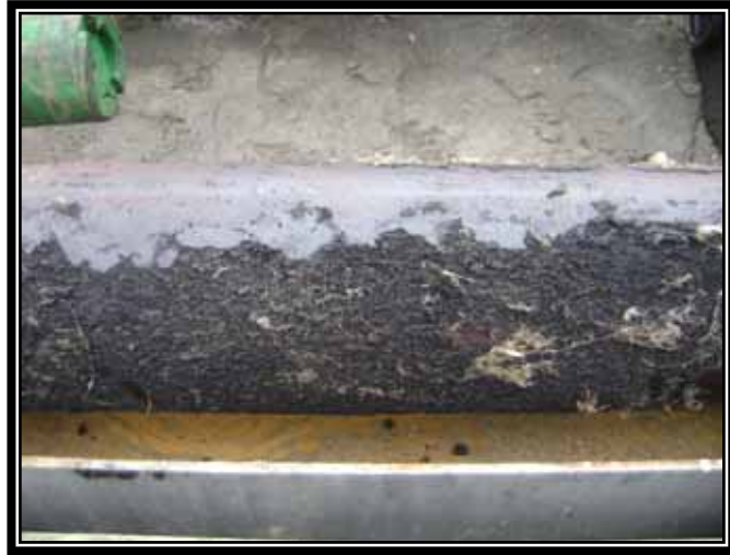
Figura 2.7 Incrustaciones en las paredes de una bomba
