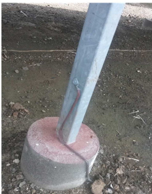
Figura. 3.32 Conexión De Mesas Al Enmallado De Tierra Perimetral
