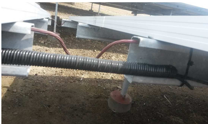
Figura. 3.31 Conexión De Tierra Entre Mesas
