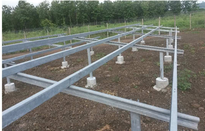
Figura. 3.27 Estructura con Inclinación 10° En La Planta Brineforcorp
