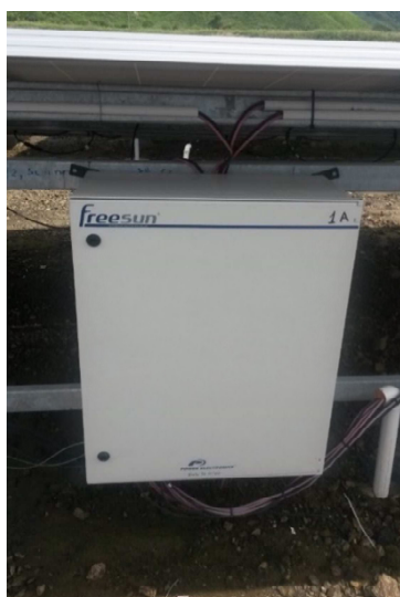
Figura. 3.30 Cableado de mesas a string box
