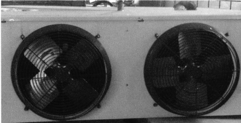
Fig. 7: Ventiladores del evaporador
