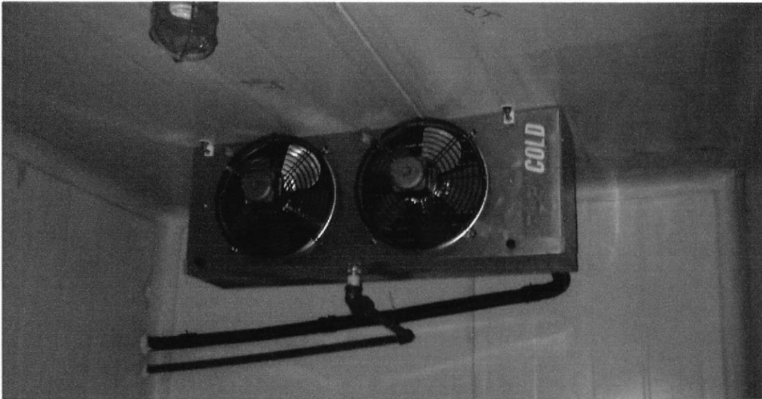
Fig. 1: Evaporador de la unidad de enfriamiento
