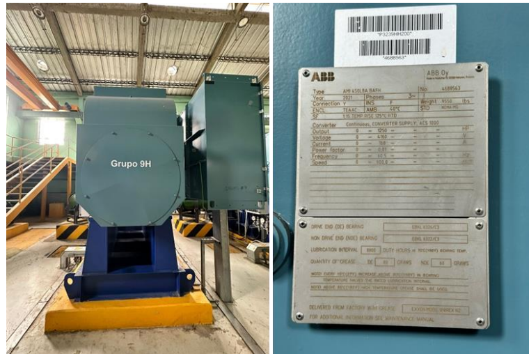
Figura 61. Grupo de Bombeo 9H y placa del motor.
