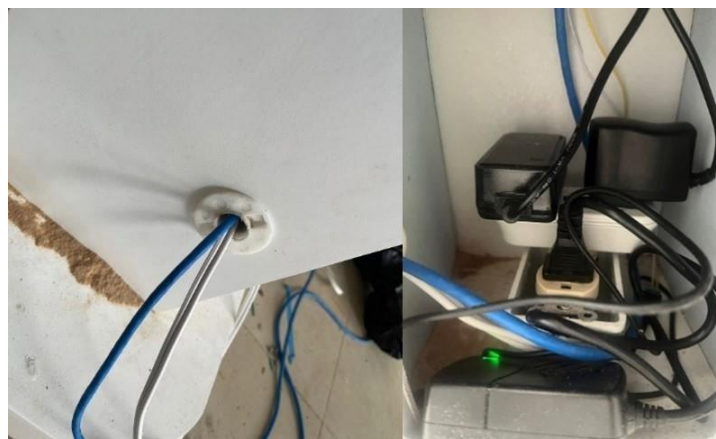
Ilustración 2.23 Central de alimentación eléctrica
