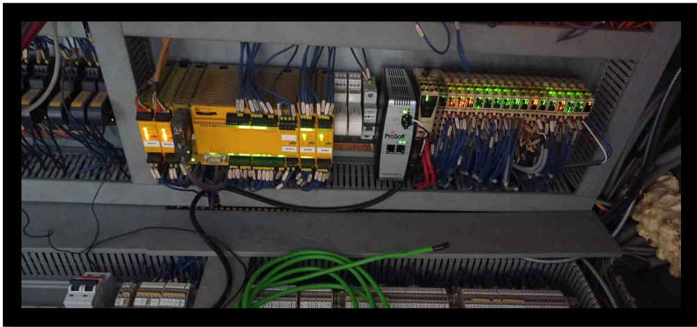
Figura 6.4. Instalación del Gateway EIP-MBTCP
