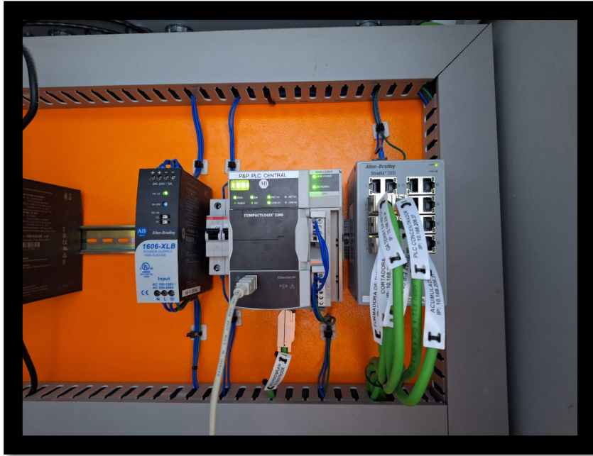
Figura 6.7. Instalación completa de los equipos de centralización
