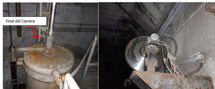
Figura 7.- Efecto del ambiente corrosivo de la TOMA 1 sobre los fines de carrera y encoder de las compuertas.
