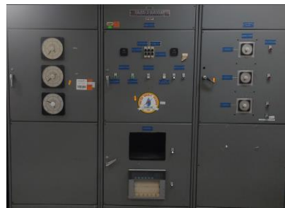
Figura 6.- Tablero de monitoreo en Presa.
