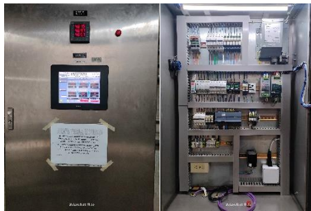
Figura 8.-Tablero T1 (nivel 84).
