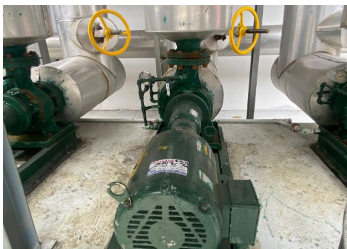
Figura 1.6 Grupo de Bombeo
