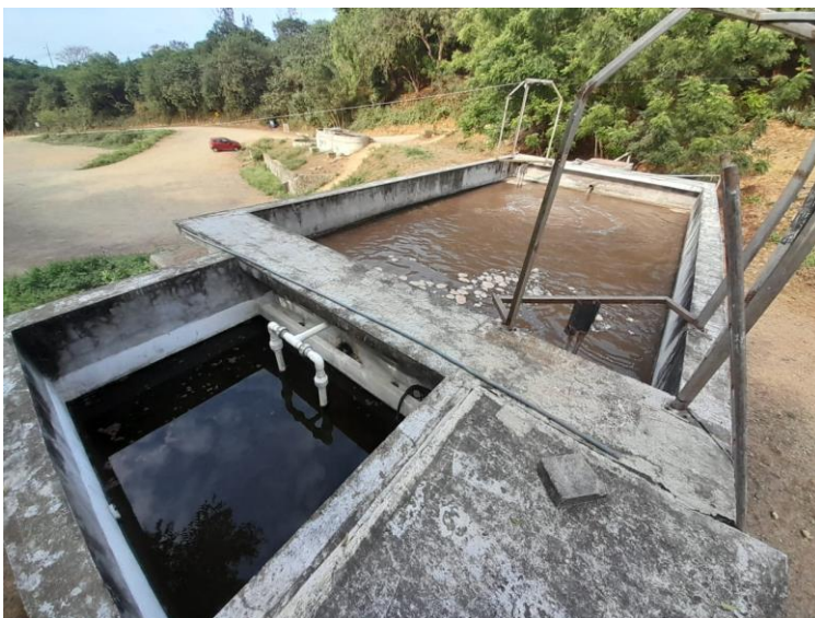
Tanque aireador y clarificador de planta depuradora
